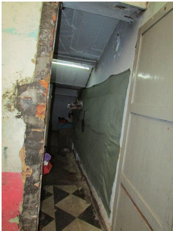
Imagen 66 Alteraciones en la estructura funcional
