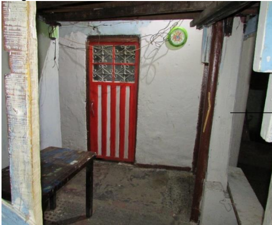
Imagen 19 Alteraciones en la estructura funcional
