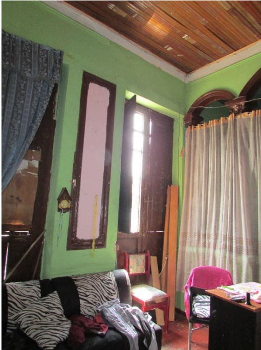
Imagen 59 Estado actual Cielo Raso y Molduras
