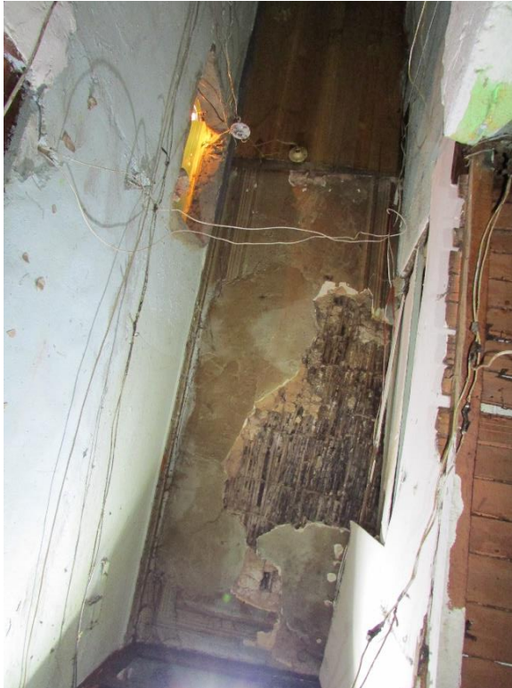
Imagen 29 Estado actual Cielo Raso y Molduras
