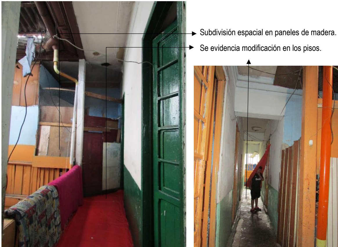
Imagen 9 Alteraciones en la estructura funcional. Subdivisión y Modificación espacial.
