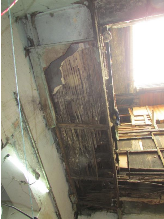
Imagen 73 Estado actual Cielo Raso y Molduras
