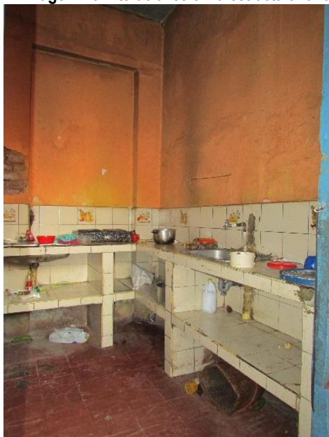
Imagen 49 Alteraciones en la estructura funcional
