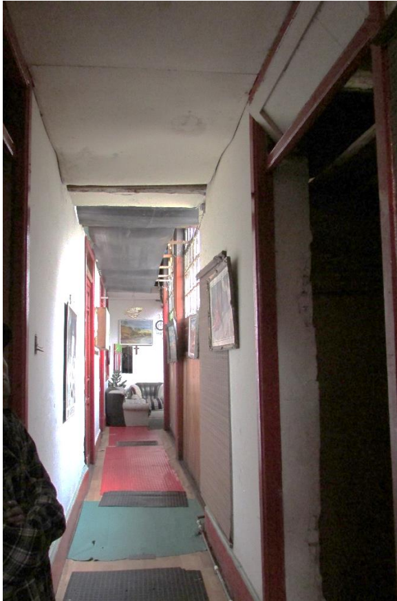
Imagen 79 Alteraciones en la estructura funcional
