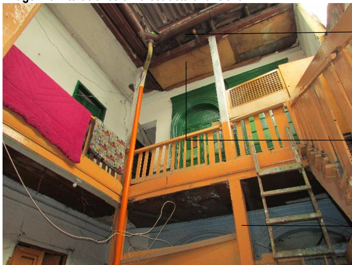
Imagen 6 Alteraciones en la estructura funcional
