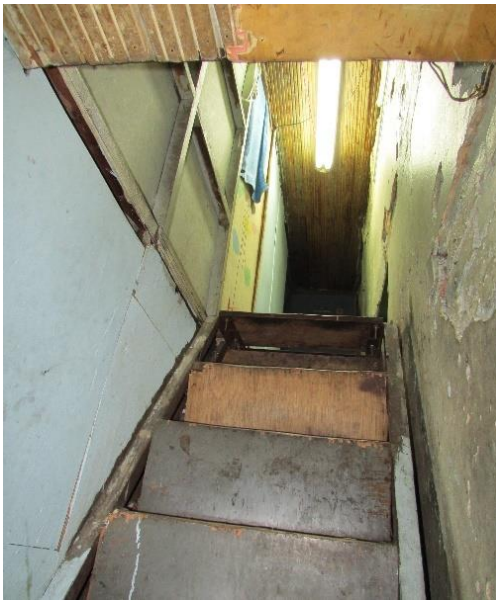
Imagen 40 Estado actual cielo raso
