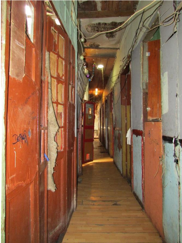
Imagen 22 Alteraciones en la estructura funcional
