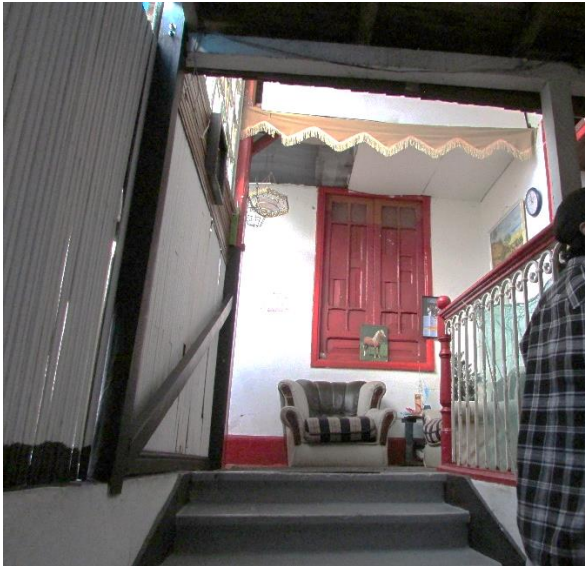
Imagen 77 Alteraciones en la estructura funcional
