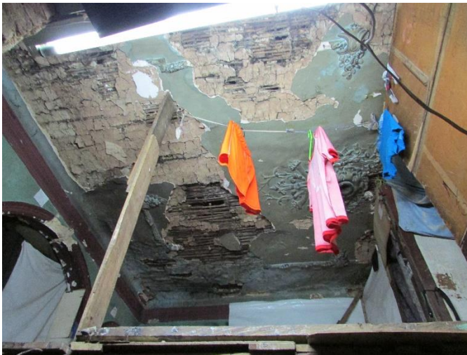
Imagen 27 Estado actual cielo raso
