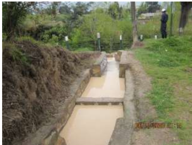
Se aprecia cuneta con dissipador de energía para el manejo de las aguas de escorrentías en la ladrillera activa con instrumento ambiental.
