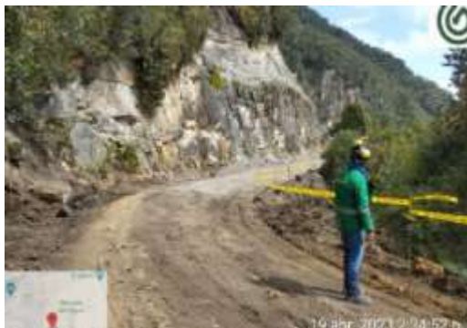
Figura 29. Avance obra en La Serranía El Zuque. Limpieza de talud para complementación de estudios de geotecnia
