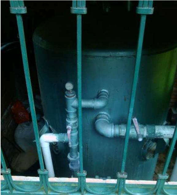
IMAGEN 7 – Planta de potabilización existente.
