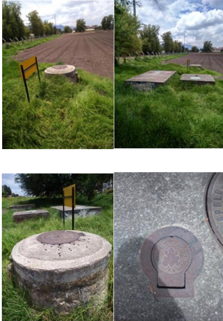
Fotografía 19. Cajas válvulas de control.
