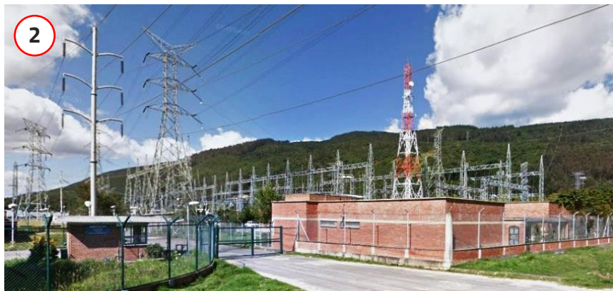
Imagen 11. Subestación Eléctrica de Torca.
