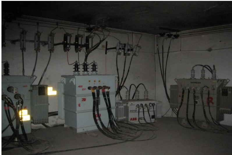
Fotografía 21: Sub estación. Transformadores principales. Fuente: Elaboración propia.
