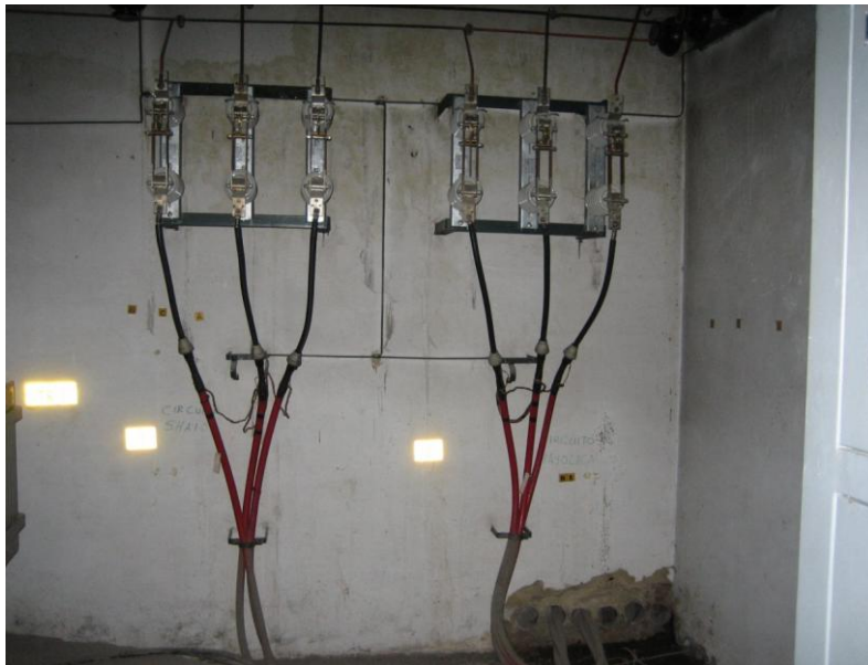
Fotografía 20: Acometidas de los dos circuitos de alimentación. Fuente: Elaboración propia.
