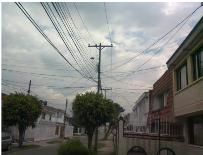
Fotografía 23: Redes eléctricas sobre la Carrera 70B Fuente: Elaboración propia.
