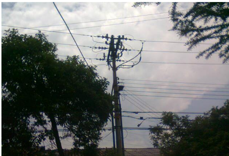
Fotografía 22: Redes eléctricas sobre la Diagonal 115A. Fuente: Elaboración propia.
