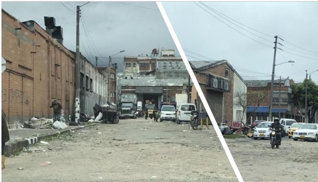
Fotografía 1. Deterioro estructural de las vías
