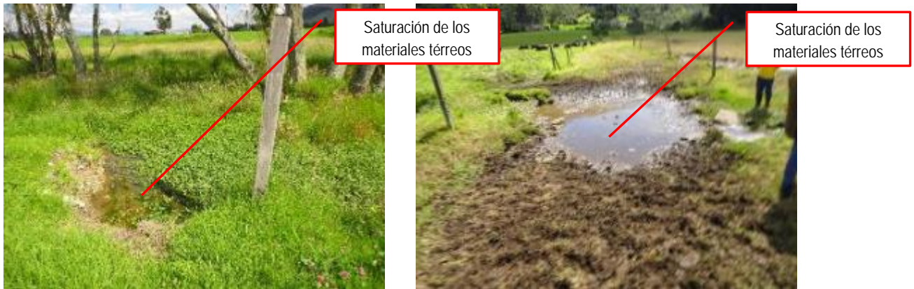
Fotografía 1.3 Saturación de los materiales térreos del predio Mazda–Mavaia.
