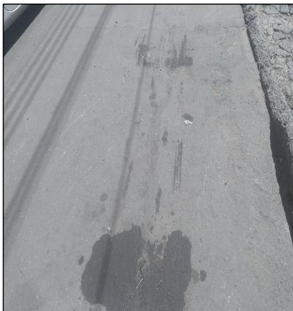
Fotografía 9. Derrames de Hidrocarburos.
