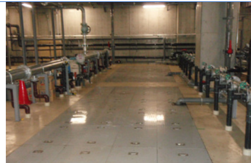
2 Sitemas de tratamiento de aguas residuales instalado en sótano de edificio de oficinas
