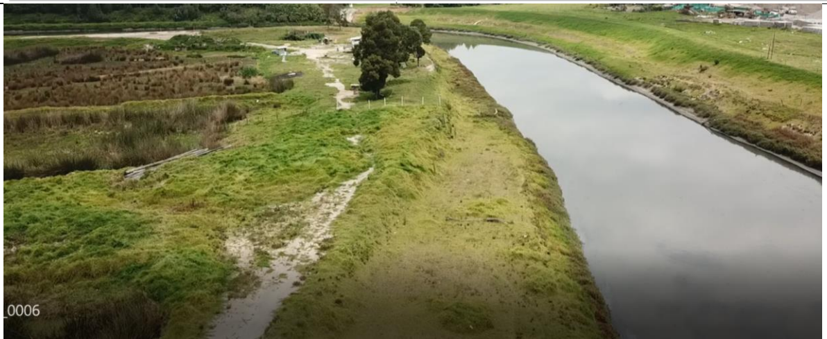
Fotografía 26. Se observa en la fotografía que no se construyó el jarillón.
