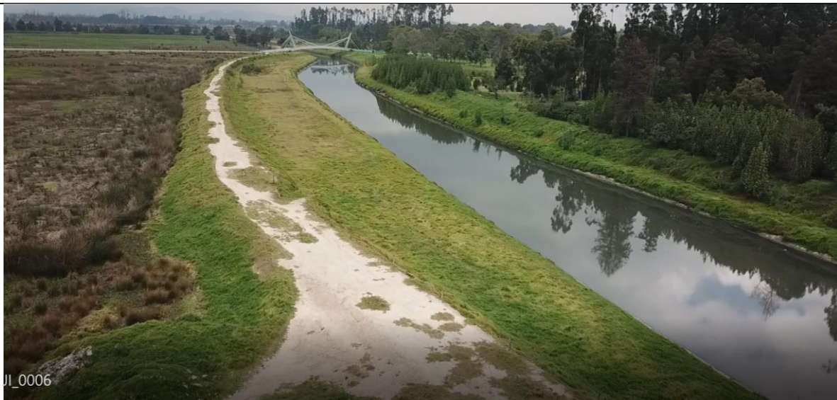
Fotografía 25. Se observa en la fotografía que se modificó el terreno diferente a como se encontraba en el diseño.
