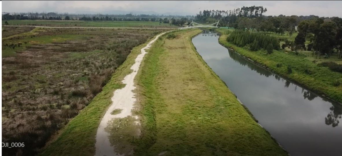
Fotografía 24. Se observa en la fotografía que se construyó la berma en el costado contrario al diseño y que el jarillón se modificó.
